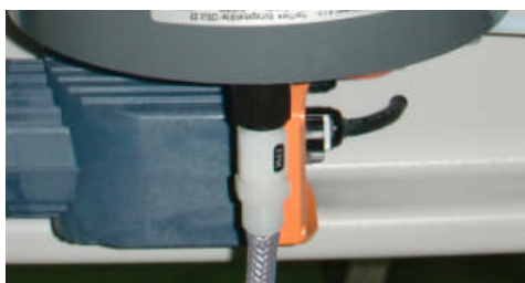
貯留槽下部 バルブ・ドレンプラグ
