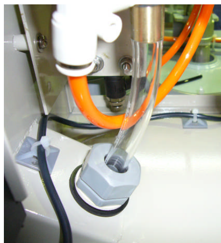
(図－10.5.2) フィーダ内部からのノズル位置
