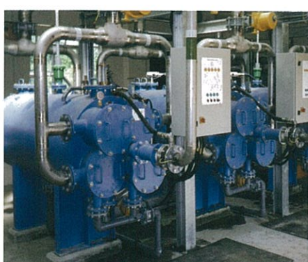
MTG×3台並列設置 (英国浄水場・日量12,000m³処理)
