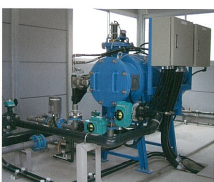
MT22P×1台設置 (広島県内浄水場・日量200m³処理)
