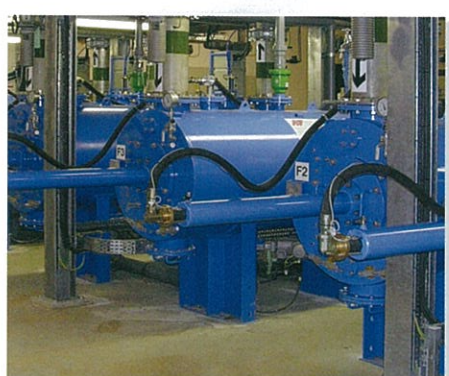
MTG×6台並列設置 (英国浄水場・日量25,000m³処理)
