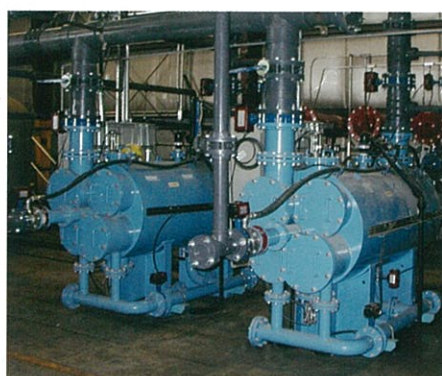
MTG×2台並列設置 (プロセス水処理・日量4,000m³処理)
