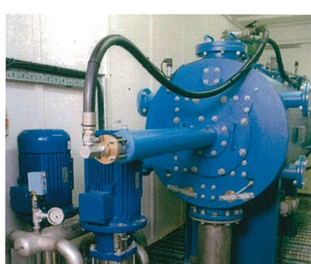
MTG×1台設置 (英国浄水場・日量3,000m³処理)
