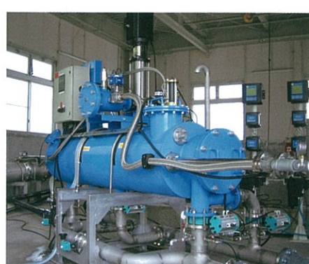
MT44P×1台設置 (国内浄水場・日量700m³処理)
