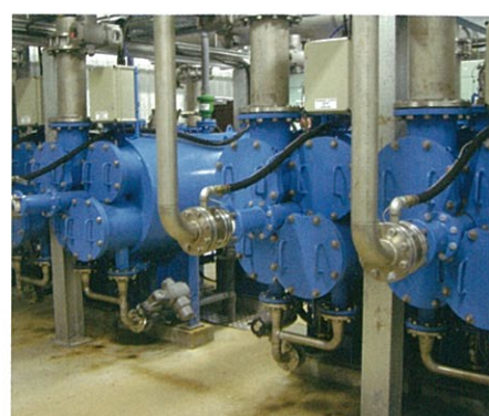
MTG×4台並列設置 (英国浄水場・日量16,000m³処理)
