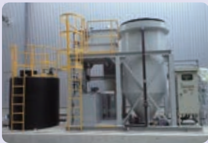
凝集沈殿システム
