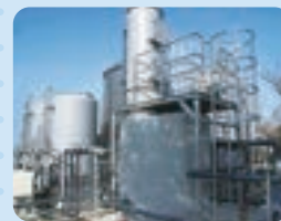
地下水アンモニア低減 生物処理装置
