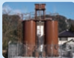
重力逆洗式ろ過装置
