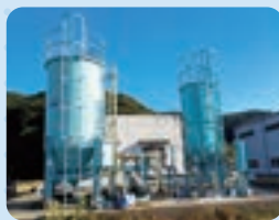
移動床式ろ過装置
